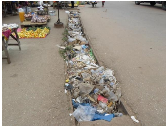
Photo 1: Obstruction des canaux d'évacuation des eaux par les ordures au quartier commerce
