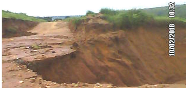
Fig. 3. L'érosion du port Saka-Saka entame la piste qui mène au port
