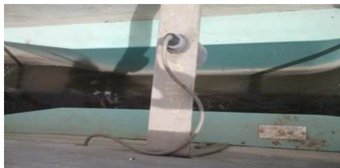
Fig. 3. Canal venturi de STEP Dar El Gueddari
