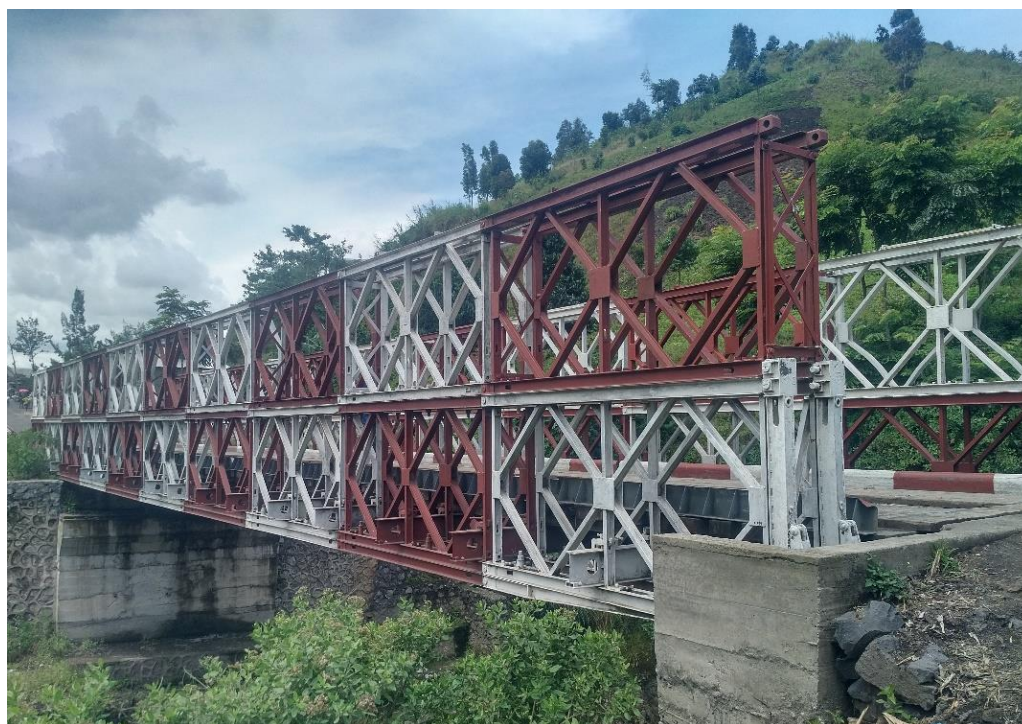
Fig. 2. Ouvrage avec poutres en acier sur culée en béton sur la rivière Kahira
