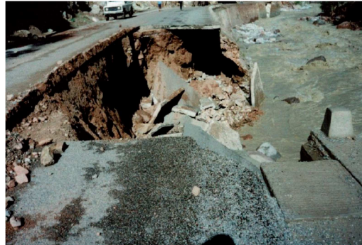
Photo 12 : Mur de soutènement de l'Ourika détruit par la crue du 28 octobre 1999 (source : [10]. saidi at al, 2010)
