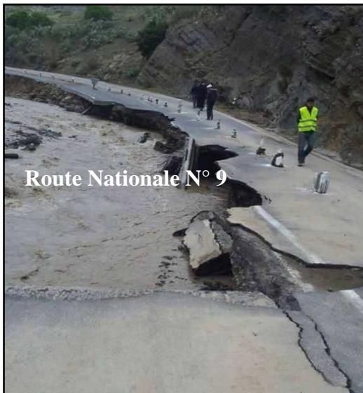
Photo 1 : destruction de l'infrastructure routière
