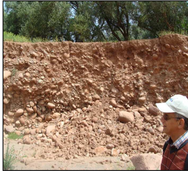
Photo 2 : dégradation des berges de l'oued
