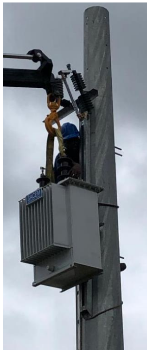
Fig. 7. Transformateur haut de poteau
