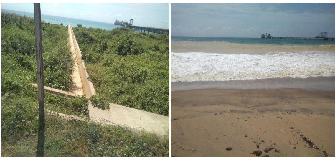
Fig. 1. Caniveaux de rejets des boues de phosphates dans la mer et pollution marine adjacente
