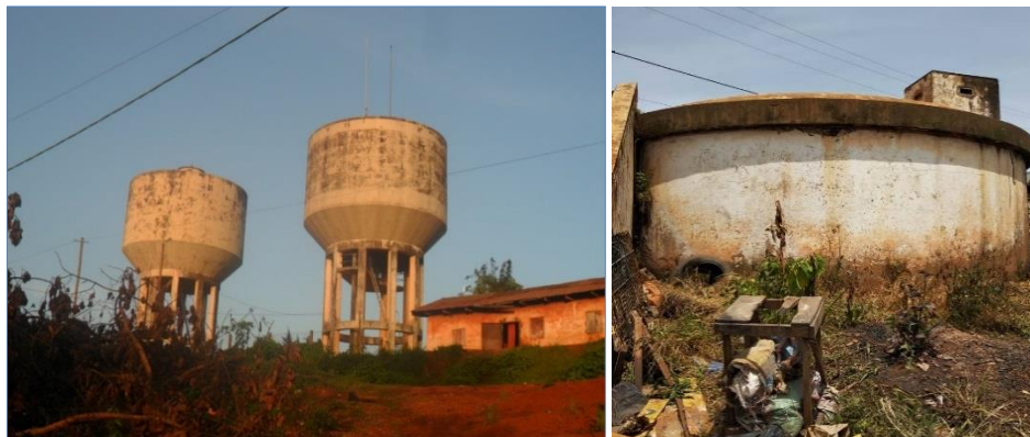
Fig. 6. Réservoirs de Banengo et Tamdja
