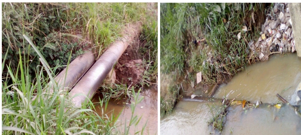
Photos 17 et 18 : traversé des pipelines au-dessus des cours d'eau affluents de la rivière N'djili et sous les eaux de la Lukaya
