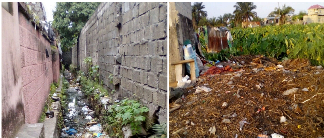
Photo 9 et 10 : caniveau bouché coincé entre deux murs + hangars d'occupation anarchique au sein du BSN
