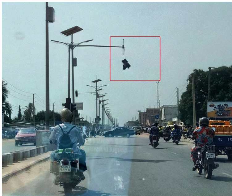
Photo N°01 : Feux de circulation en état de dégradation avancée
