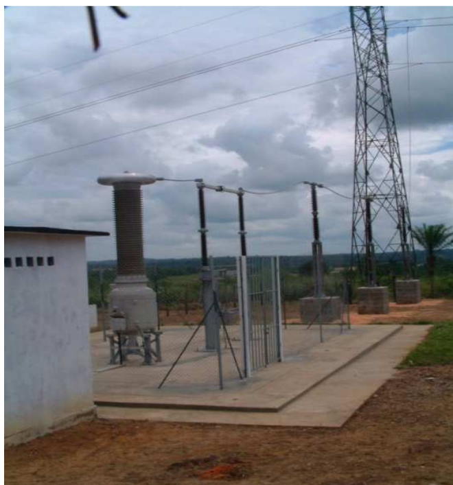
Fig. 5. Le poste au PLX réalisé à Makola
