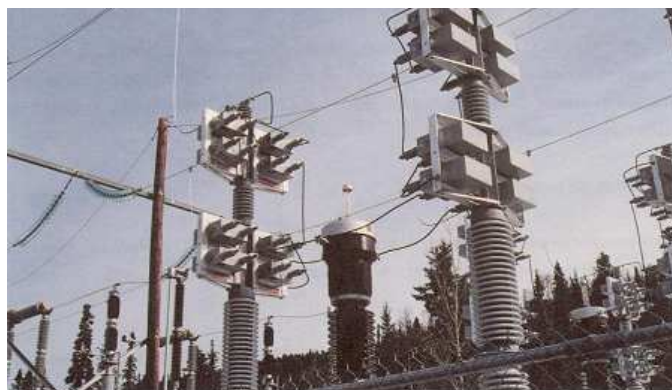
Fig. 6. Poste à diviseurs capacitifs
